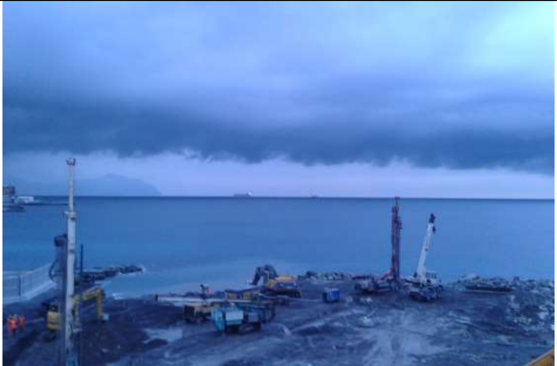
Sullo sfondo dei lavori in Corso Italia per la realizzazione dello Scolmatore, un rovescio autunnale (@meteofotografando - Luca Onorato)
