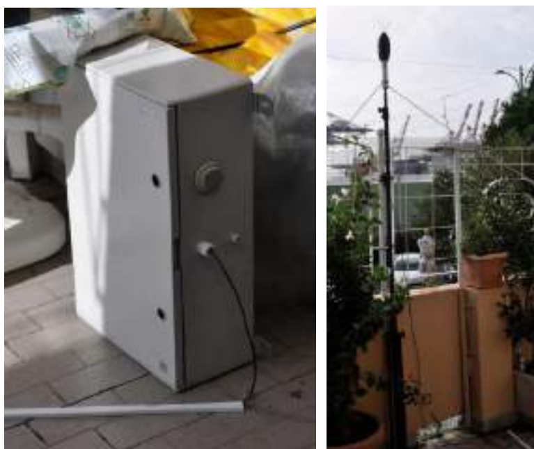
Figura 8: immagini fotografiche dell'alloggiamento della strumentazione per la misura in continuo
